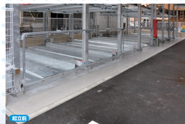
(広島市 南区) コンツェルトパーク宇品 機械式駐車場前に設置 【有効幅10.15m 有効高0.5m 2基】
